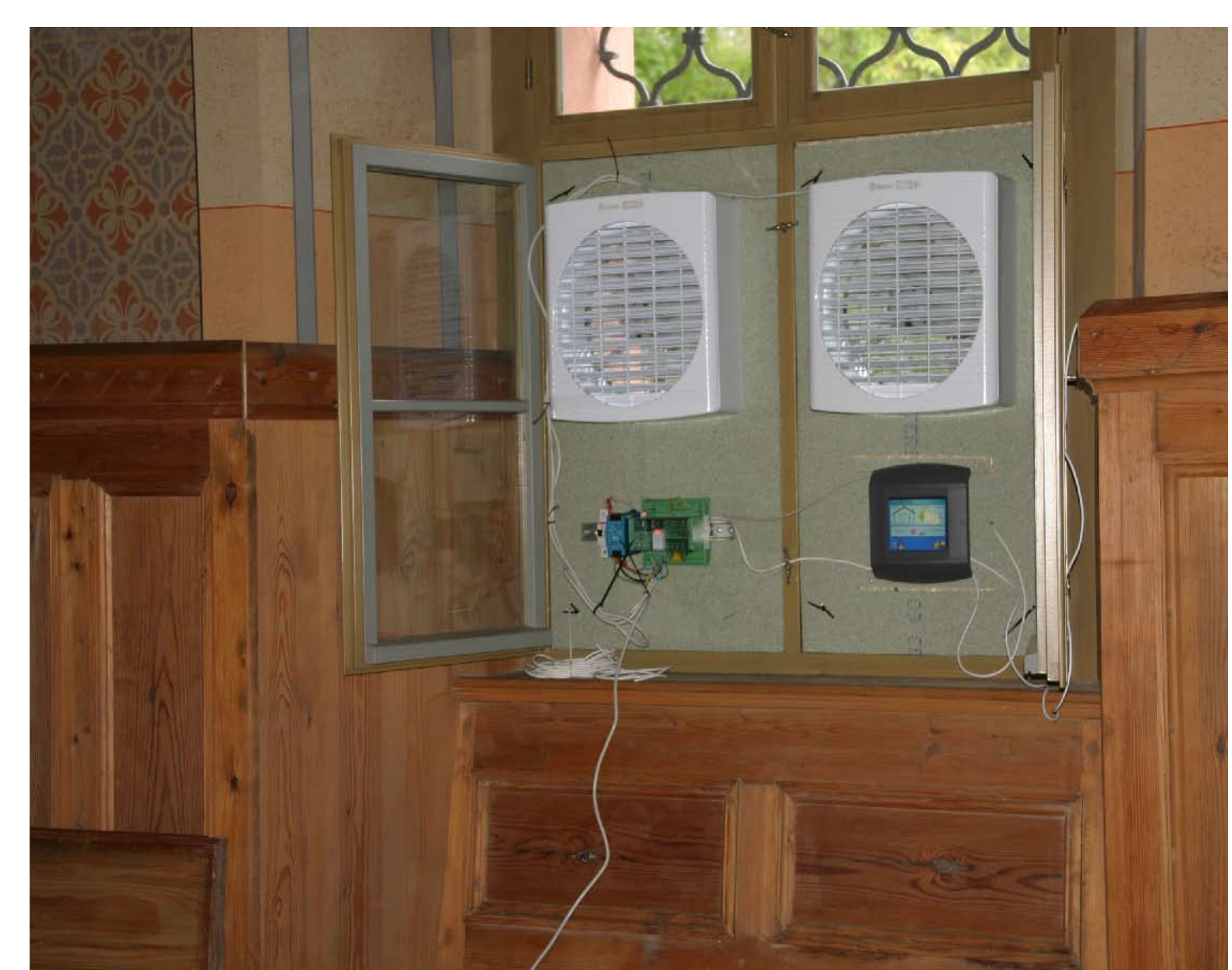
Abb. 9: Sakristei Klosterkirche: sensorgesteuerte Lüftungsanlage
