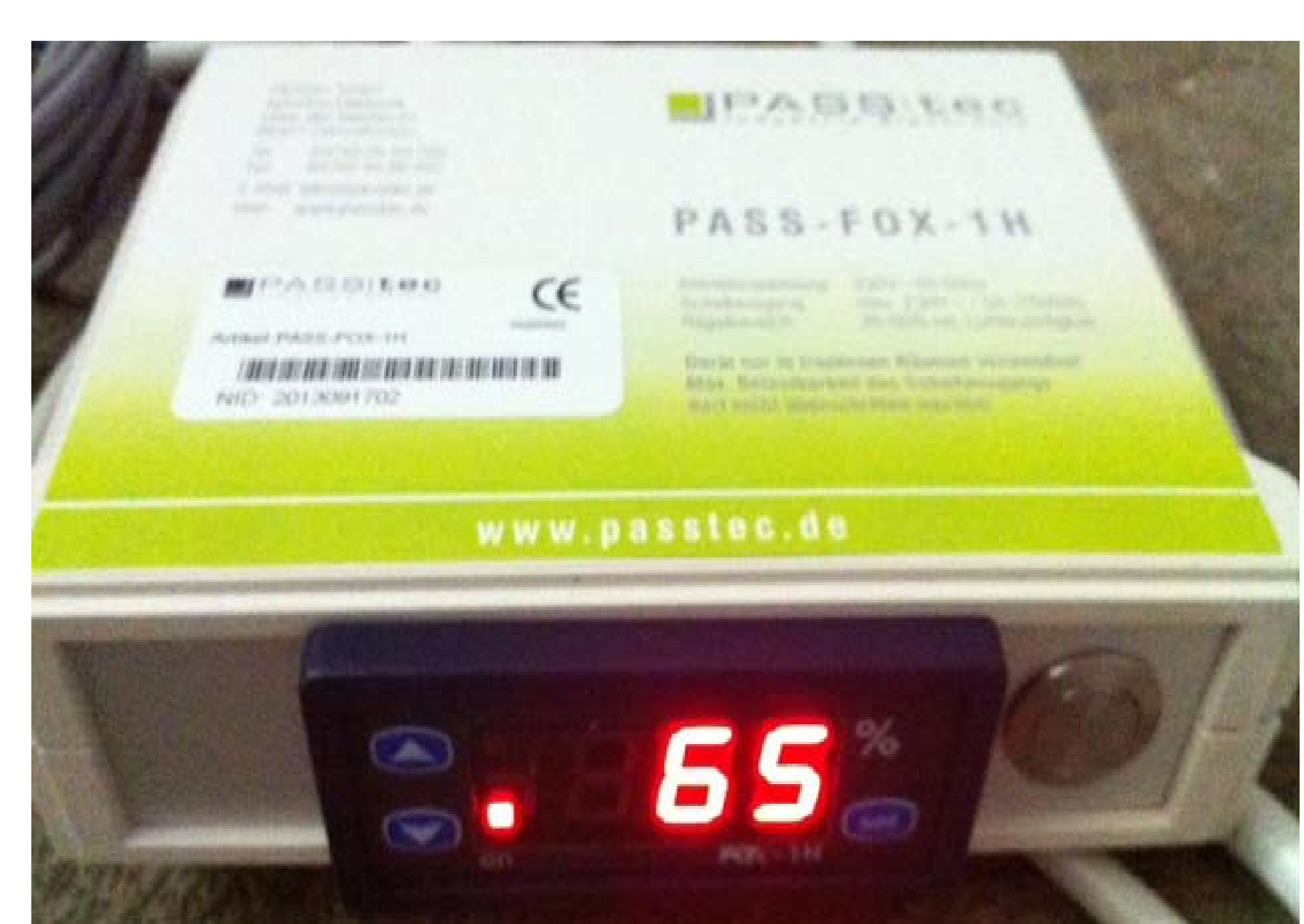
Abb. 6: Steuerpanel zur Beeinflussung der relativen Raumluftfeuchte
